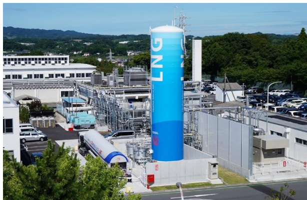
LNGサテライト全景
